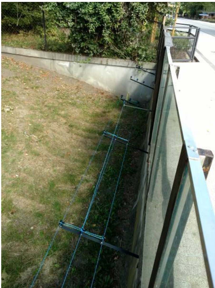
Fot. nr 14. Widok przewodów pod napięciem („pastch”) na terenie MOZ.
